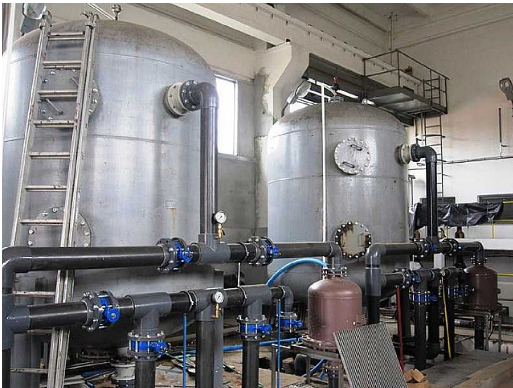
Stacja uzdatniania wody Kozłowa Góra
